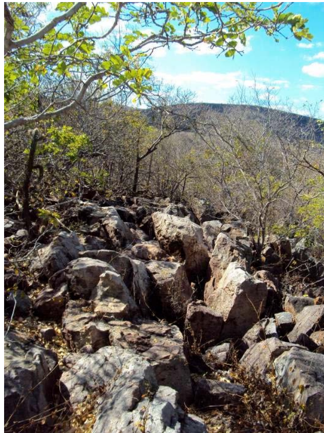
Figura 3.1: Ombreira esquerda do eixo Lontras, onde foi observado indícios de anomalias geológicas que poderiam condicionar o projeto da barragem.
